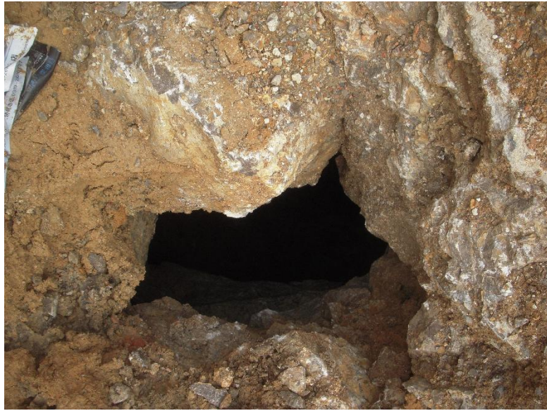
照片 5-9 基坑开挖发现的溶洞
