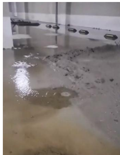
图 5-3 青青小镇西区地下车库渗水
