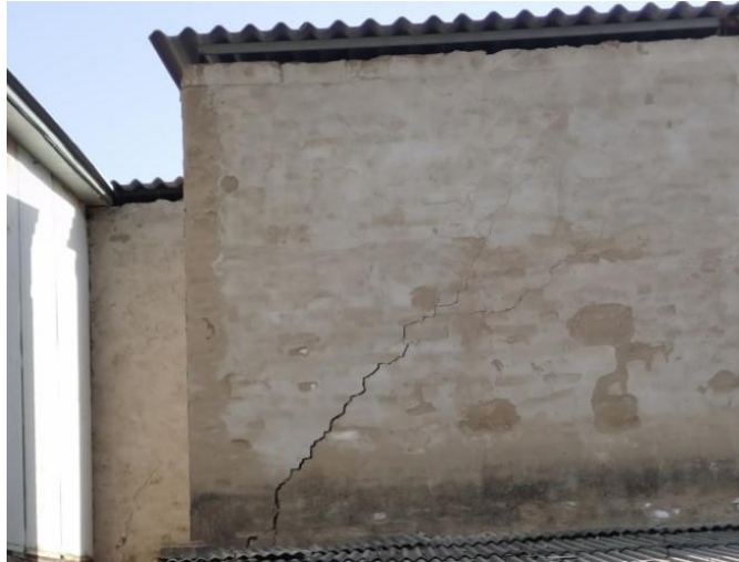
照片 5-1 狗头泉附近民房上的裂缝
