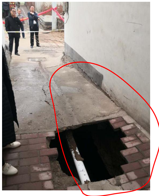
照片 5-11 塌陷坑分布范围
