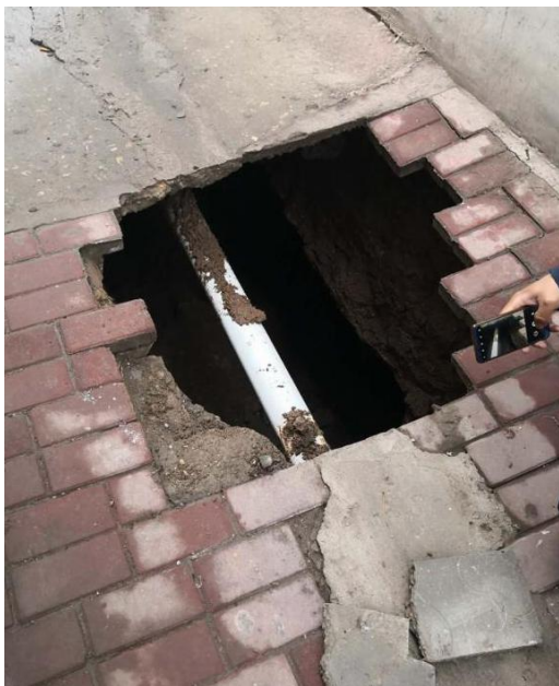
照片 5-10 塌陷坑坑口
