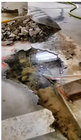
照片 5-2 襄湾壹号地下车库渗水
