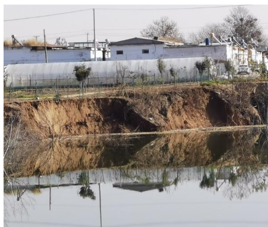
照片 5-5 百泉边坡破坏
