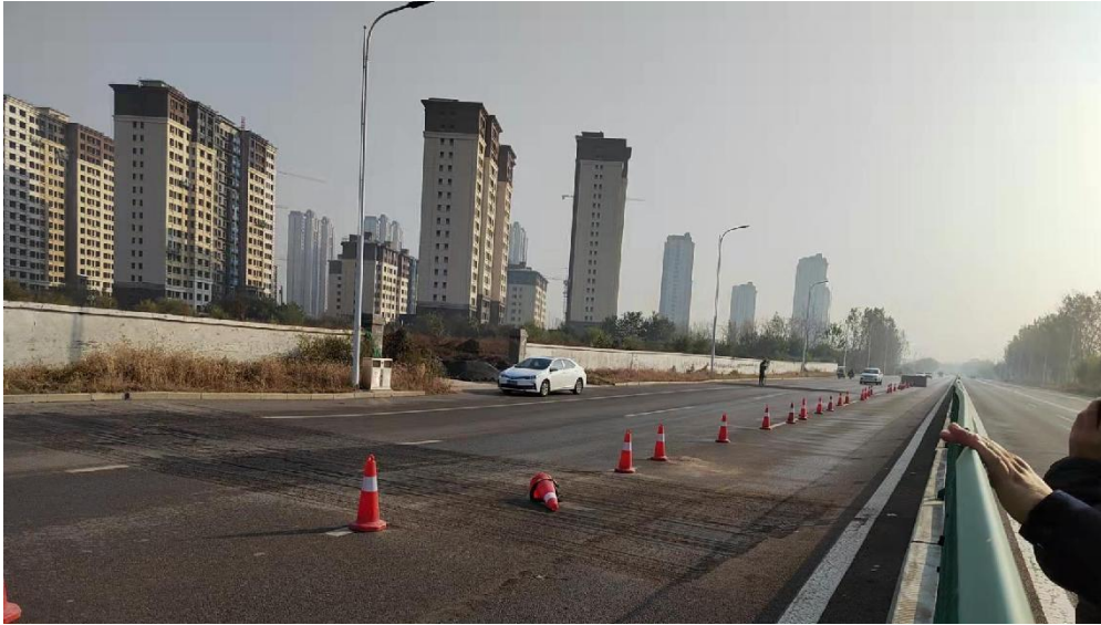
照片 5-6 百泉大道地面塌陷路段
